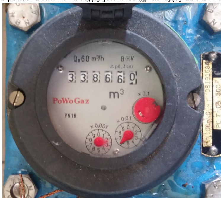
Rys. 7 Wodomierz na rurociągu 225mm
