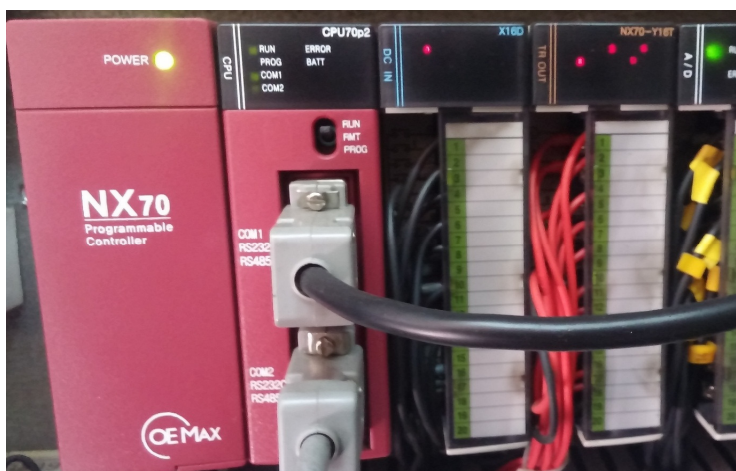
Rys. 8 Sterownik sterujący hydrofornią Grojec
