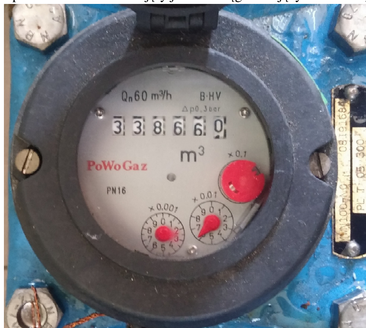
Rys. 7 Wodomierz na rurociągu 225mm
