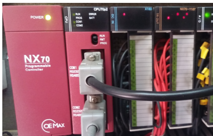
Rys. 8 Sterownik sterujący hydrofornią Grojec
