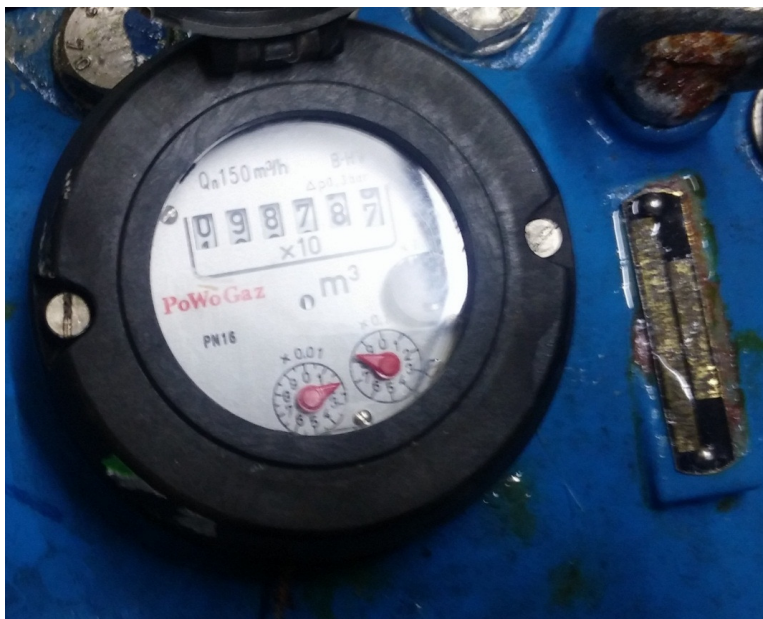
Rys. 5 Wodomierz na rurociągu zasilającym miasto
